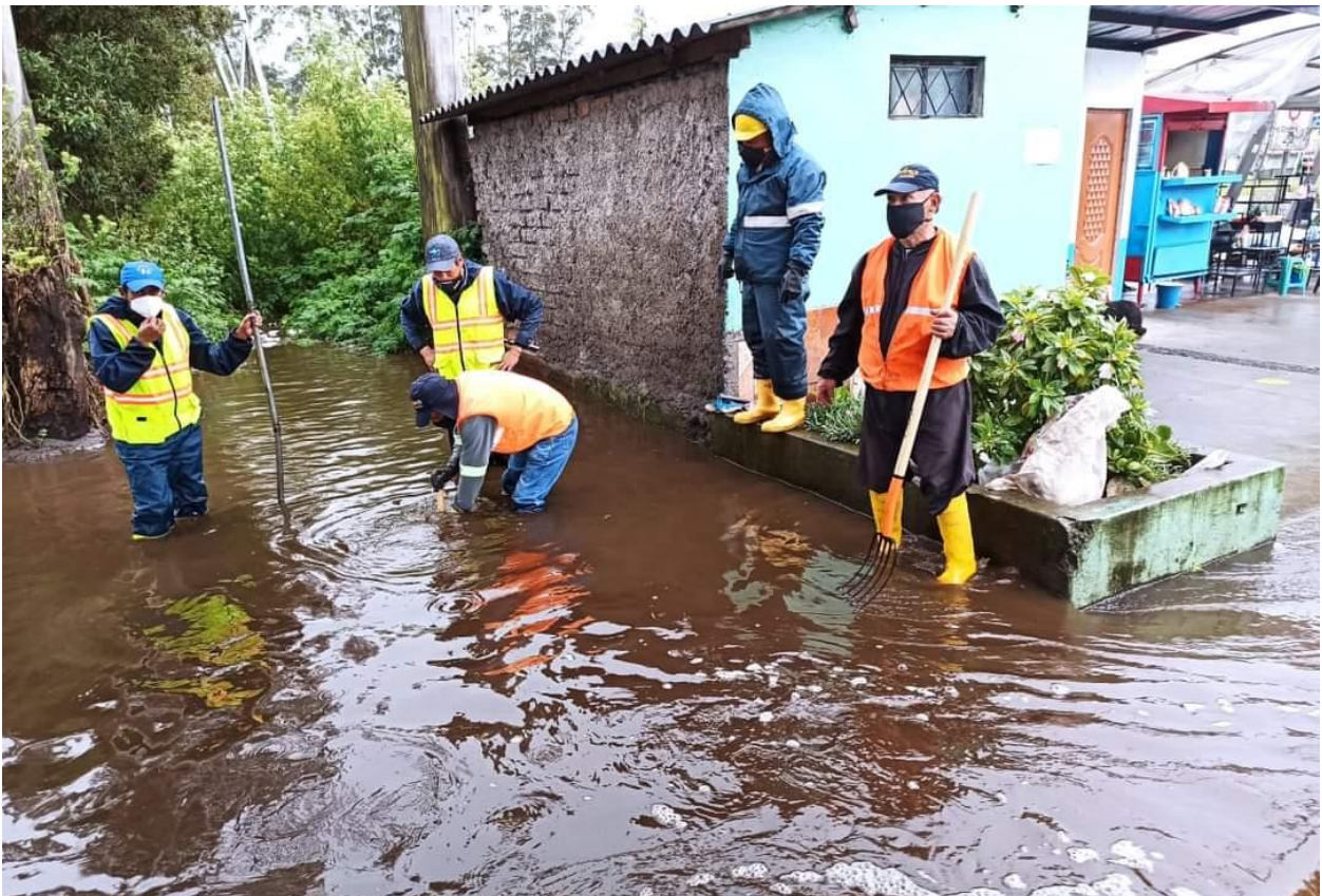
Ilustración 36. Aguas servidas acequias Sector "El Obelisco" 2
